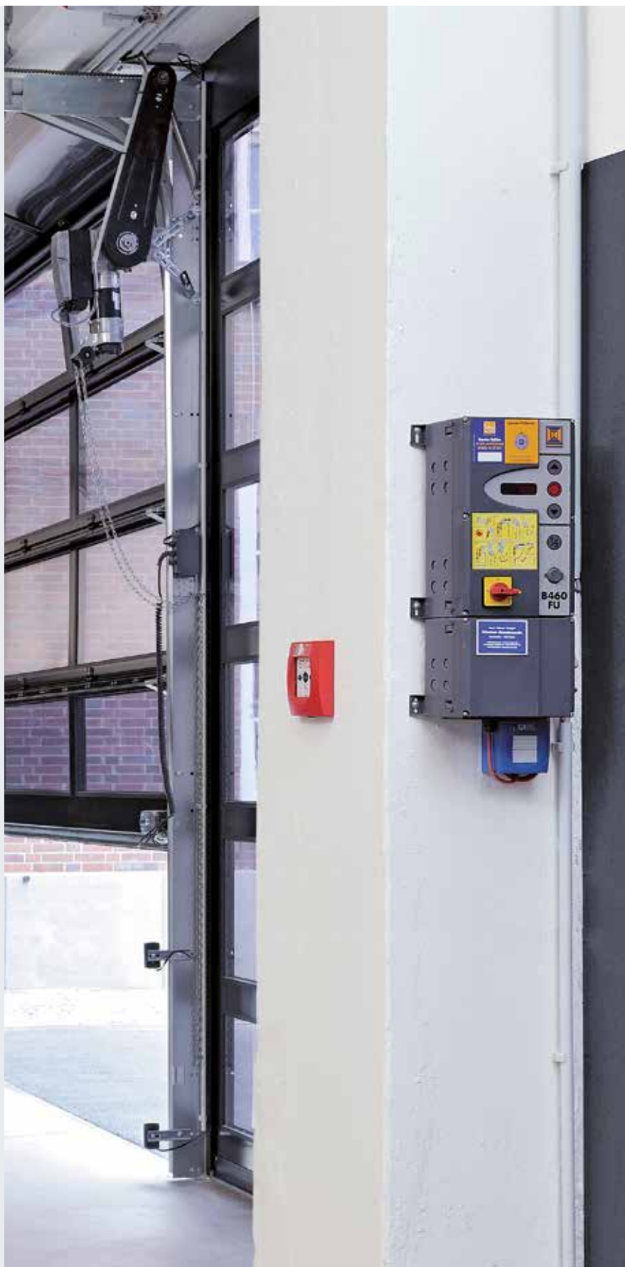
Jednoduchá inštalácia vďaka systémovým komponentom
